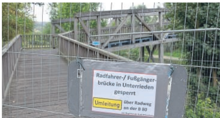
Seit Mitte August gesperrt: die Fußgänger- und Radfahrerbrücke zwischen Unterrieden und Witzenhausen.
